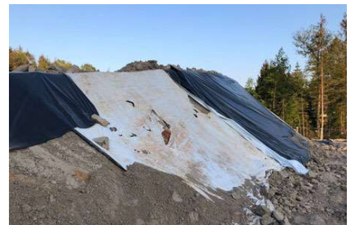
2 Mit Hexyl kontaminiertes Haufwerk, Mai 2023.
