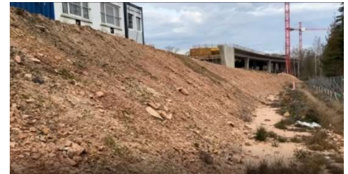
1 Kontaminierte Dammaufschüttung am Talbauwerk Kirschbrückhege. Mai 2023.
